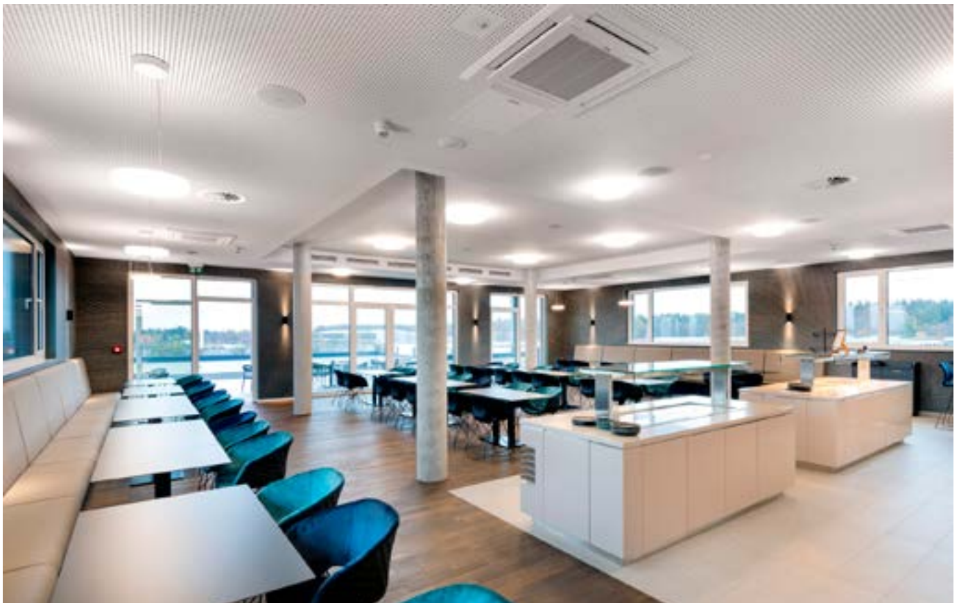
Auch der Küchenbereich wird über die raumlufttechnische Anlage kontinuierlich mit frischer Luft versorgt. Dafür wird die Frischluft durch Außengeräte der Mr. Slim-Serie vorkonditioniert.
