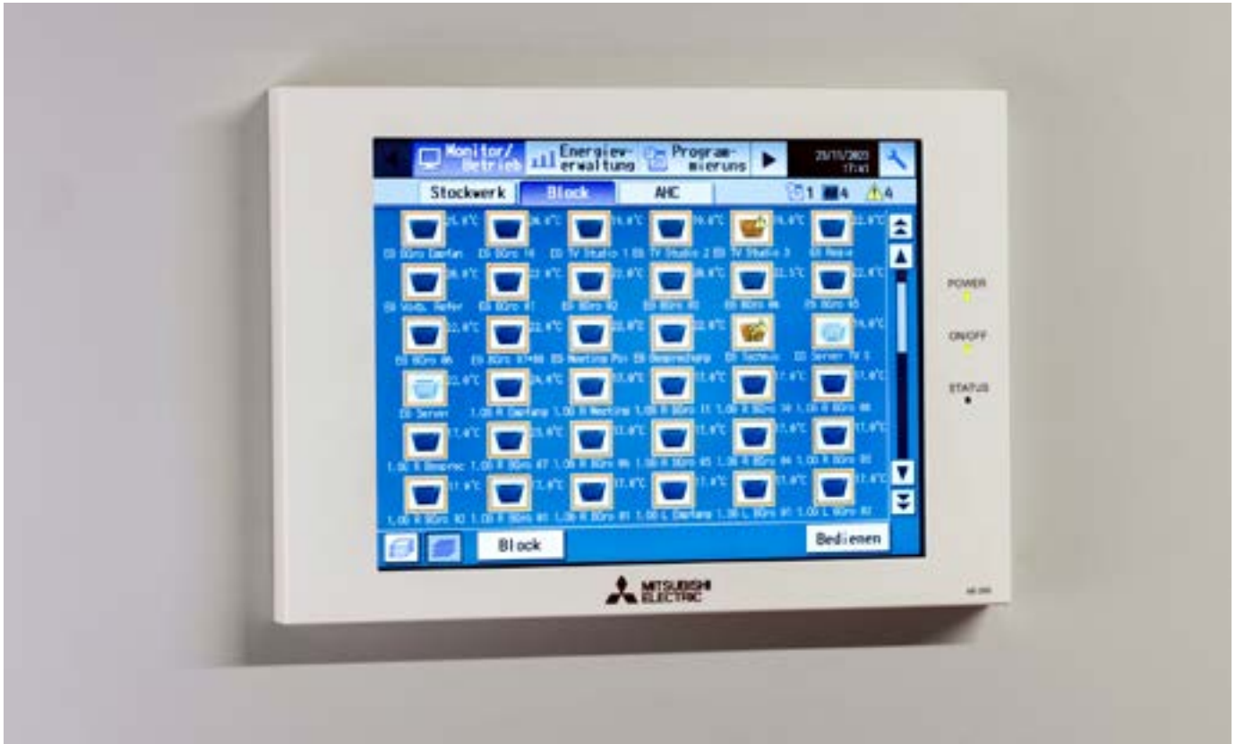
Sämtliche Klimageräte des Konferenz-Zentrums sind an eine AE200-Systemfernbedienung angeschlossen und in den KNX-Standard zur Gebäudeautomation eingebunden.
