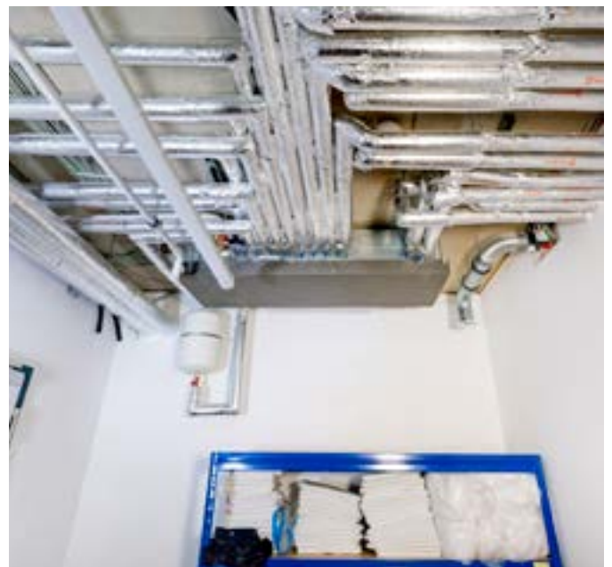
Jeder Außeneinheit ist ein Hybrid BC-Controller in einem Technikraum zugeordnet, an den die Klimageräte angeschlossen sind.
