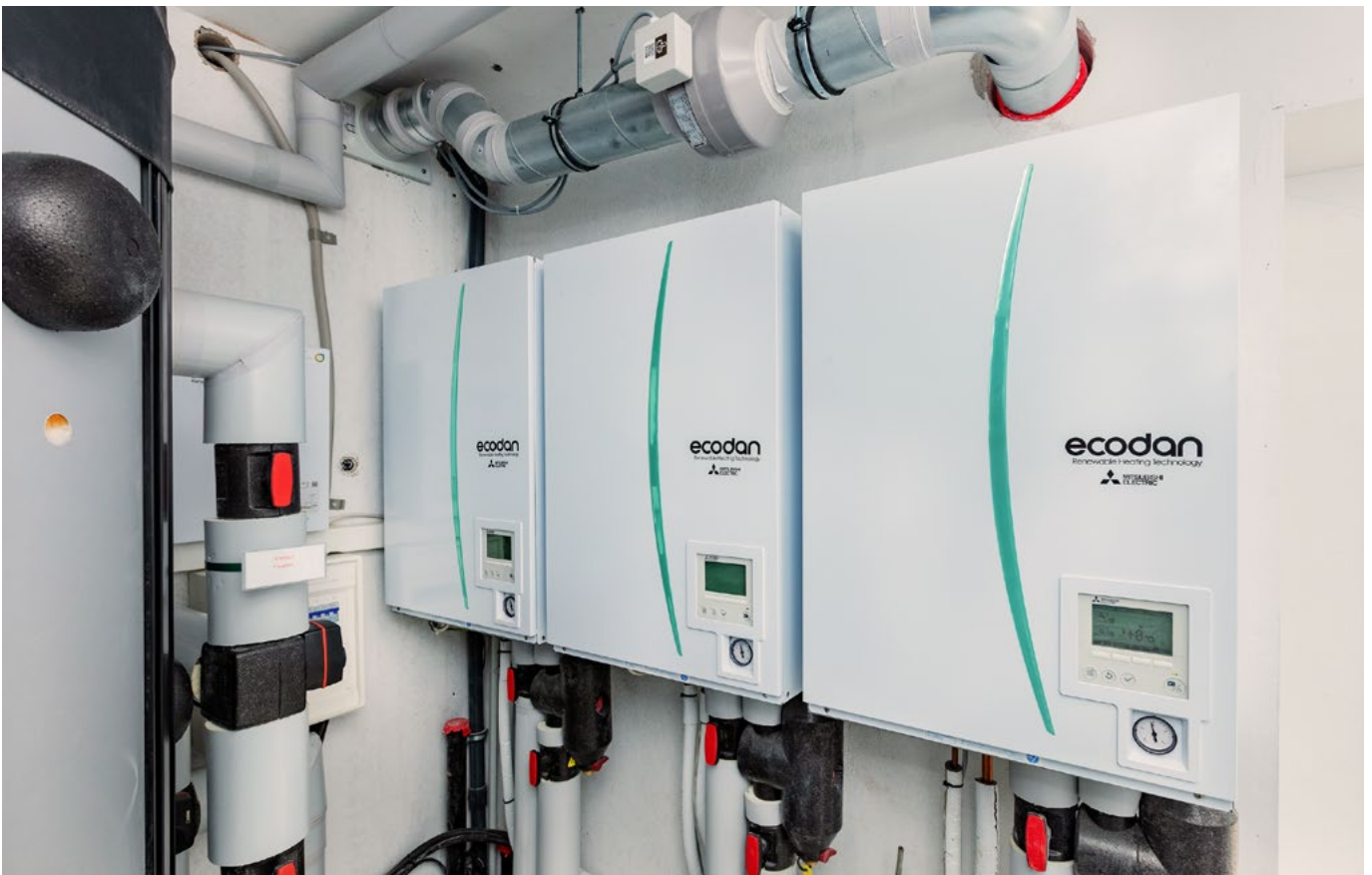
Für jede Außeneinheit steht ein Hydromodul im Technikraum zur Verfügung, um die Heiz- und Wärmepumpenkreisläufe hydraulisch voneinander zu entkoppeln.
