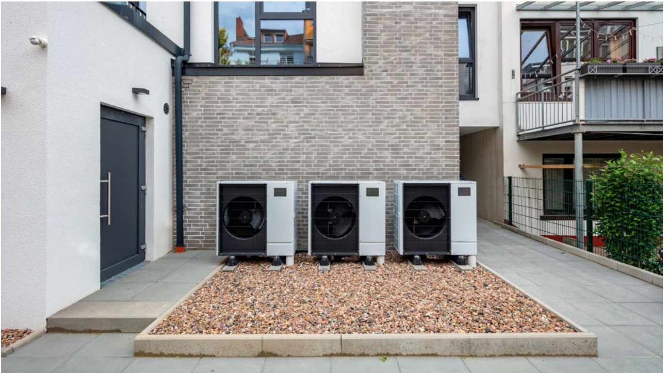
Zum Einsatz kommen drei kompakte Ecodan Luft/Wasser-Wärmepumpen mit Zubadan Inverter-Technologie des Herstellers Mitsubishi Electric, die als Dreier-Kaskade installiert wurden.
