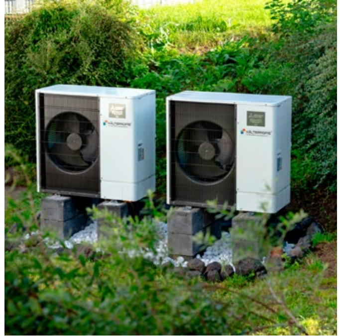
Zum Einsatz kommen Ecodan Luft/Wasser-Wärmepumpen von Mitsubishi Electric, die als Zweier-Kaskade im Außenbereich installiert wurden.
