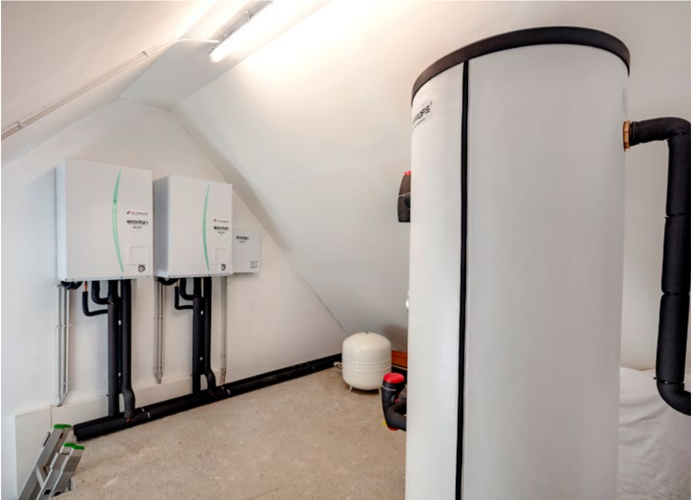
Die Technikzentrale ist im Dachboden eines kleinen Nebengebäudes untergebracht.
