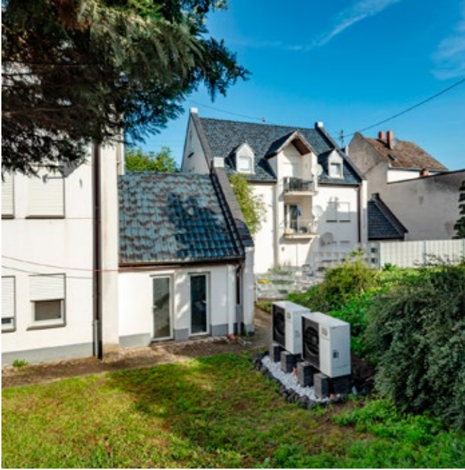
Als Energiequelle nutzen die Wärmepumpen die in der Umgebungsluft enthaltene Energie.
