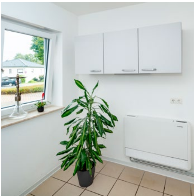
Im Zuge der Heizungsmodernisierung wurden die alten Heizkörper durch iLife-2 SLIM Eco-Konvektoren von Mitsubishi Electric ersetzt.
