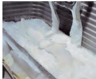
Eisbildung am Außengerät ohne Wannenheizung
